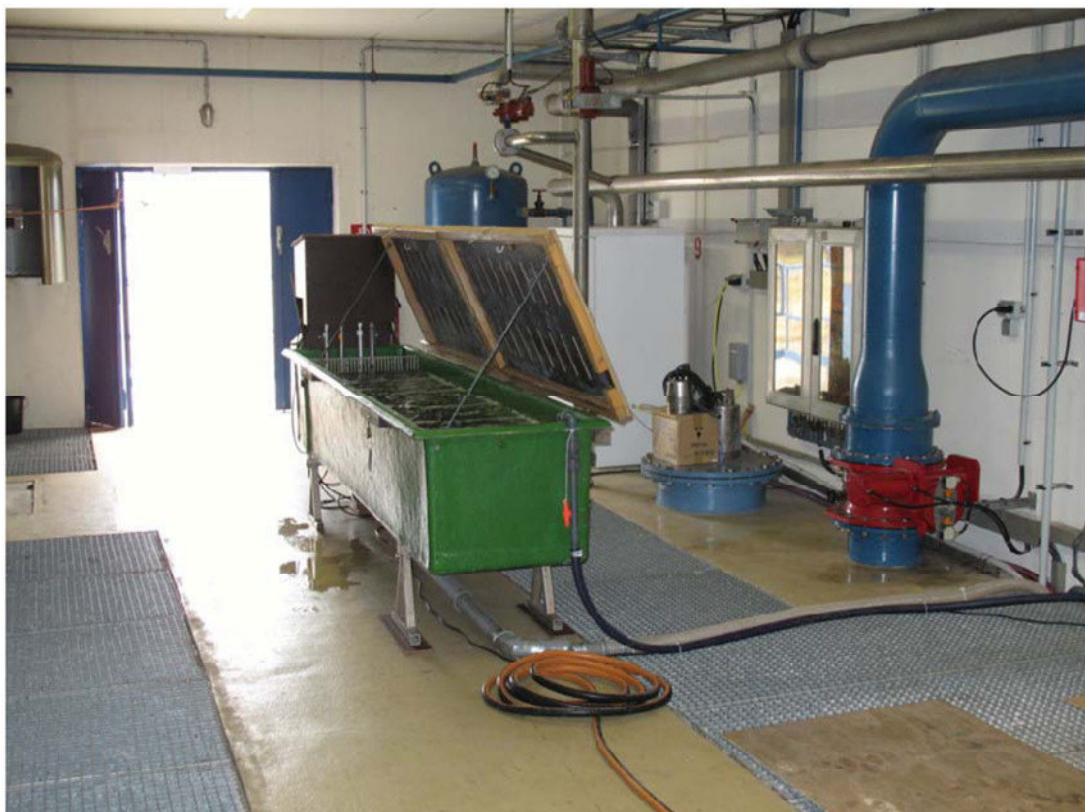
Abbildung 3: Langstromrinne zur Fischexposition mit Online-Messsonden auf dem Gelände der Kläranlage Mannheim
