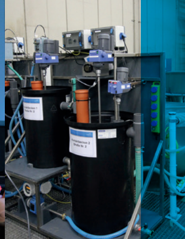
KomS-Versuchsanlage zum Einsatz auf Kläranlagen
