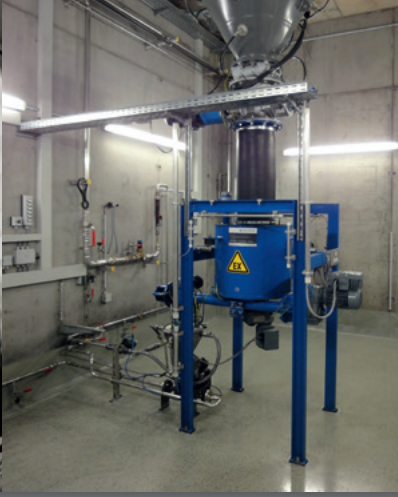
Kläranlage Kressbronn, PAK-Dosiereinrichtung
