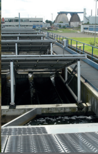
Kläranlage Mannheim, Filter mit granulierter Aktivkohle
