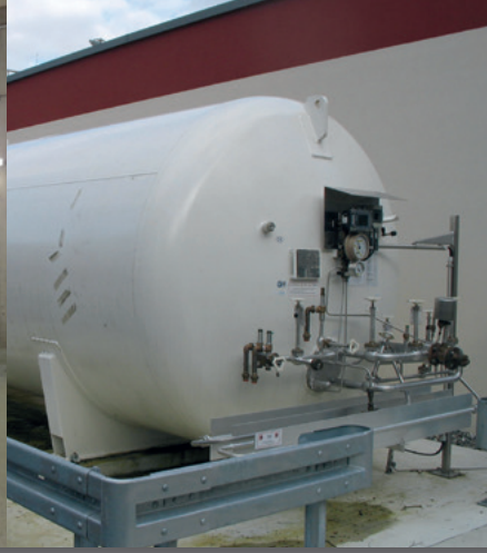
Kläranlage Eriskirch, Sauerstofftank für die Ozonanlage
