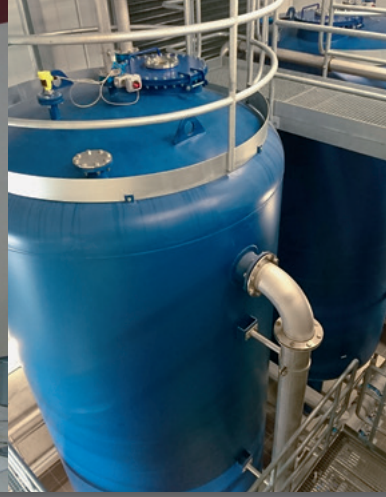
Kläranlage Westerheim, GAK-Filter
