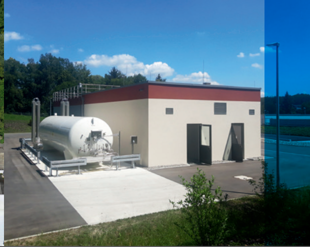
Kläranlage Eriskirch mit Ozonung
