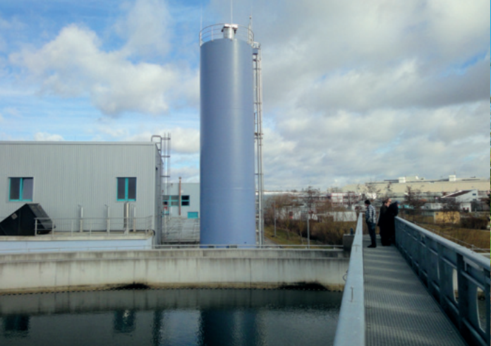
Kläranlage Böblingen-Sindelfingen, Adsorptionsstufe mit Pulveraktivkohle
