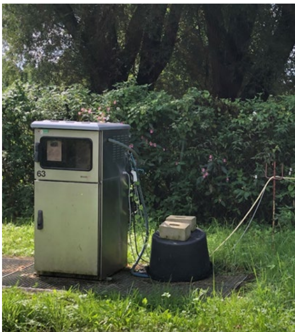
Abbildung 4.3: Probenehmer Ablauf RBF To-belbach (eigene Aufnahme)
