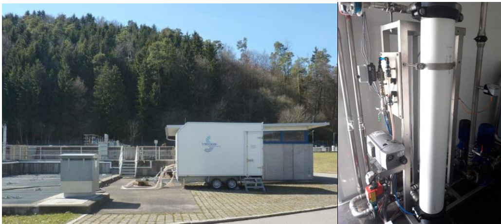
Abbildung 2: Ultrafiltrationsanlage des Unternehmens Strecker Wassertechnik GmbH
