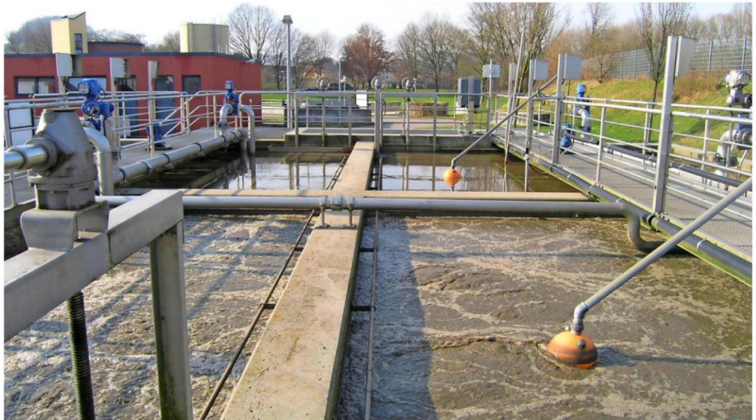
Spurenstoffe wie Arzneimittel oder Biozide sollen mit einer speziellen Anlage in der Kläranlage Öhringen aus dem Abwasser beseitigt werden.
