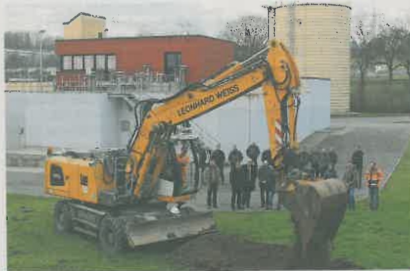
Mit einem symbolischen Baggerbiss begann die erneute Erweiterung des Öhringer Klärwerks. Bis Pfingsten 2017 werden gut 3,7 Millionen Euro verbaut. Foto: Peter Hohl
