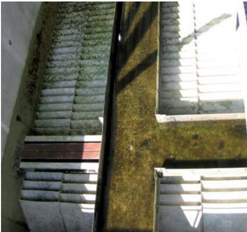
Abb. 2 Lamellenabscheider im Sedimentationsbecken
