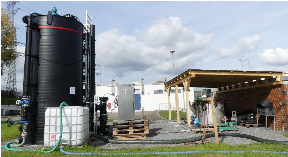
Abbildung 2-2: Versuchsfläche auf der Kläranlage Neckarsulm, links Versuchsreaktor, rechts überdacht, Dosierstoffbevorratung
